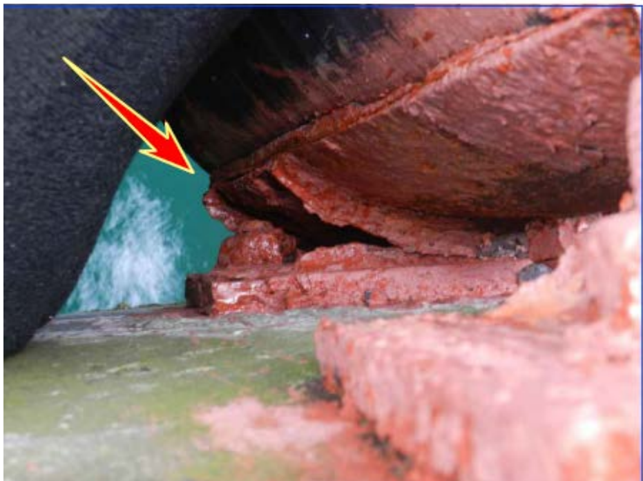
Рис. 3.4.4 Разрушение элементов крепления отбойных устройств
