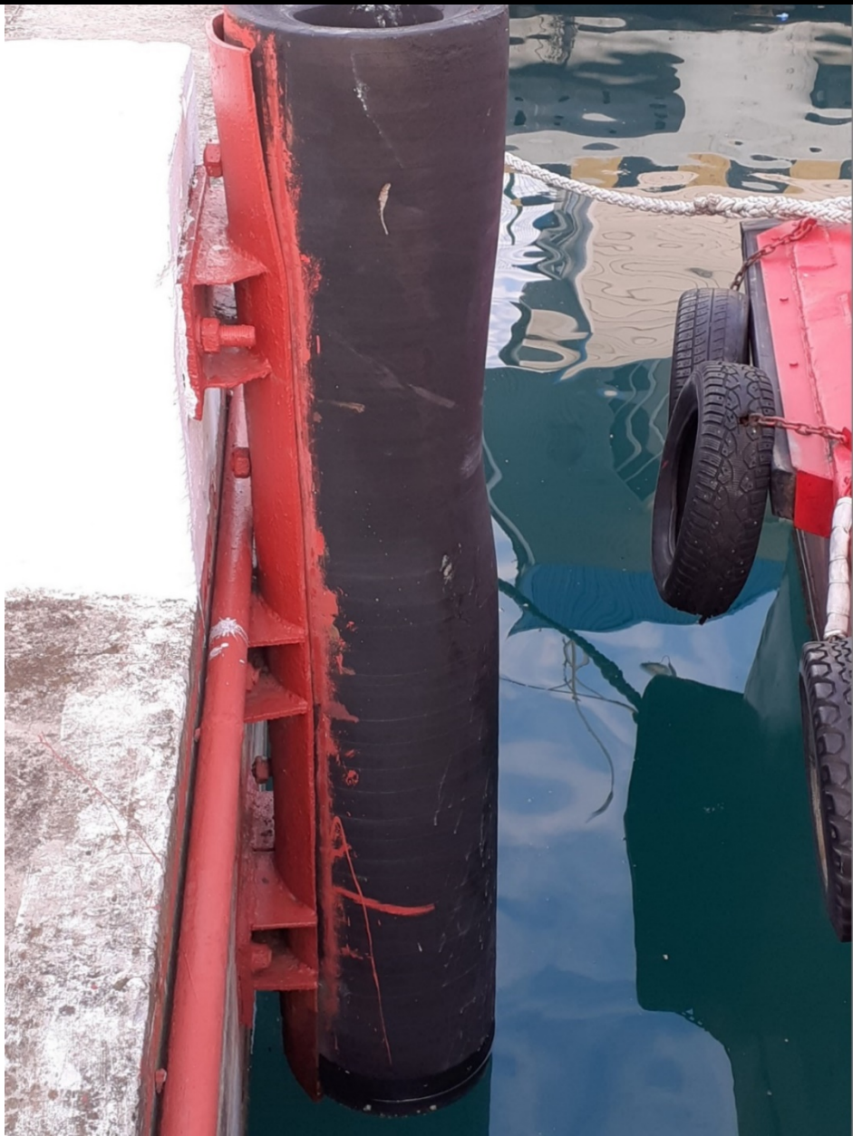
Рис. 3.4.1 Деформация элементов крепления и резинового цилиндра УО1
