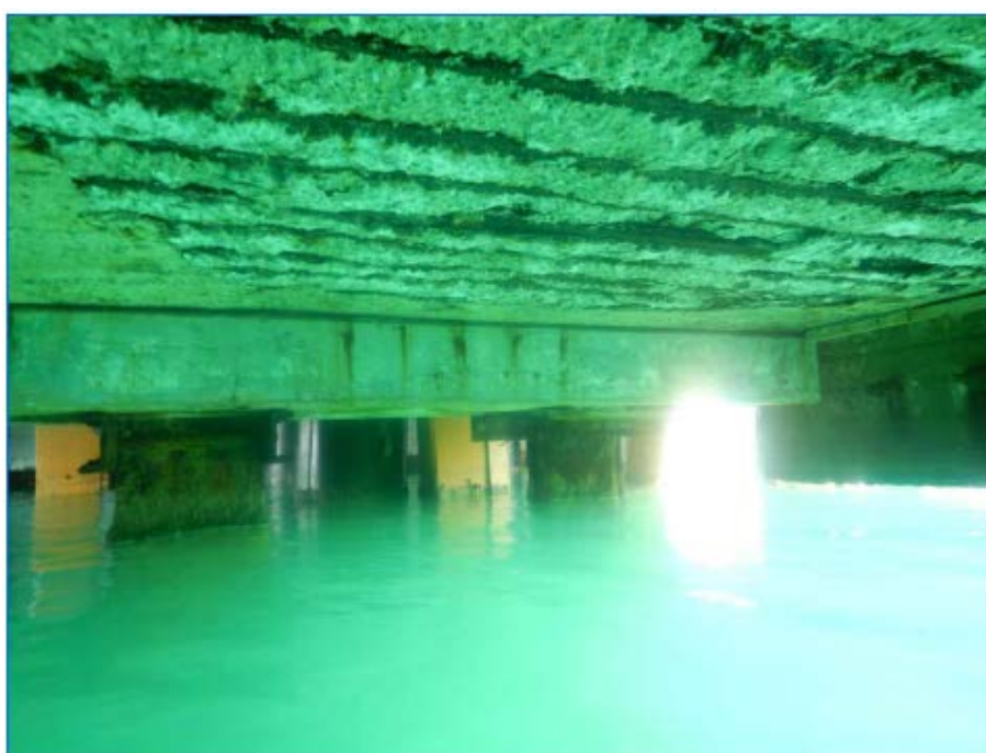
Рис. 3.3.2-3.3.4 Участки нижней поверхности плит с разрушением защитного слоя бетона с оголением и коррозией арматуры
